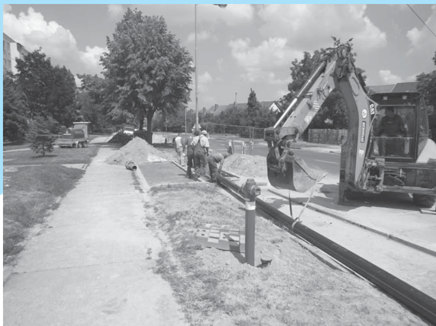
A nyár a közműrekonstrukciók szezona is. Képünkön a veszprémi Lóczy utcai ivóvízvezeték-rekonstrukció munkálatai láthatók.
